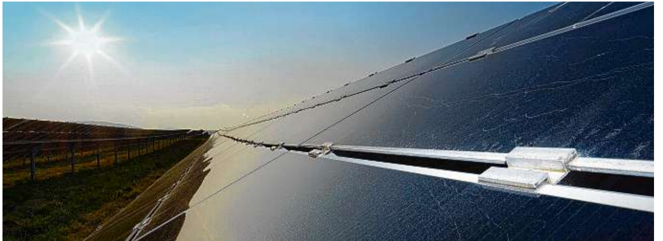
Bei Solarstrom hat der Landkreis Konstanz was zu bieten. Auf der ehemaligen Deponie in Rickelshausen wird Energie für rund 4000 Haushalte produziert. BILD: GERALD JARAUSCH
